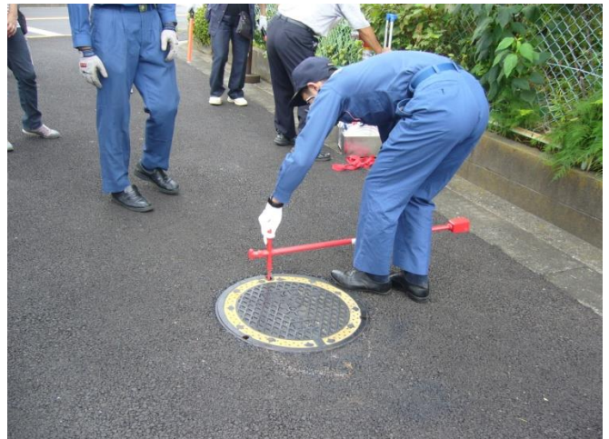
A地点の丸型消火栓の蓋開閉
