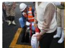
角形の消火栓
