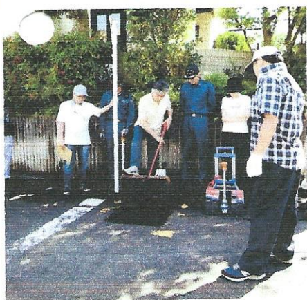
→ ドライバーでマンホールの蓋を開ける。← 同閉める
